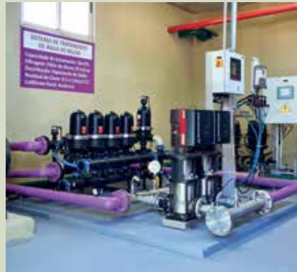
GS INIMA AMBIENT EFFLUENT REUSE SYSTEM
