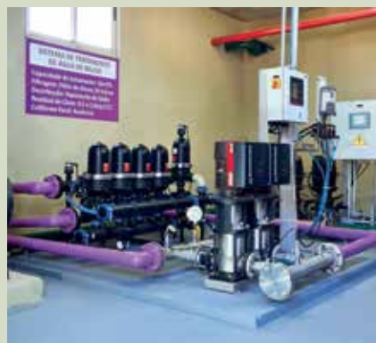
SISTEMA DE REÚSO DE EFLUENTES DA GS INIMA AMBIENT
